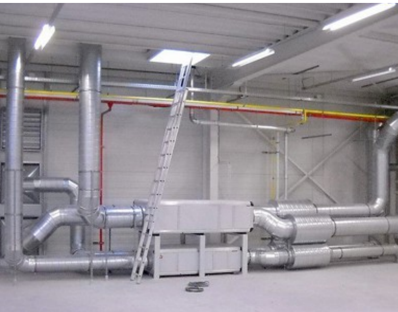
Ventilatie vertegenwoordigt een groot deel van de omzet
